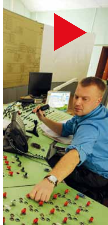
Дежурный по станции парка прибытия Сергей Веткин направляет прибывающие поезда на нужные пути.
